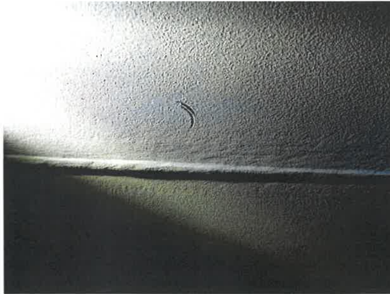
Abb. 23, Bereich DB1 / DB2 außen / Anhang 4, Position 11
