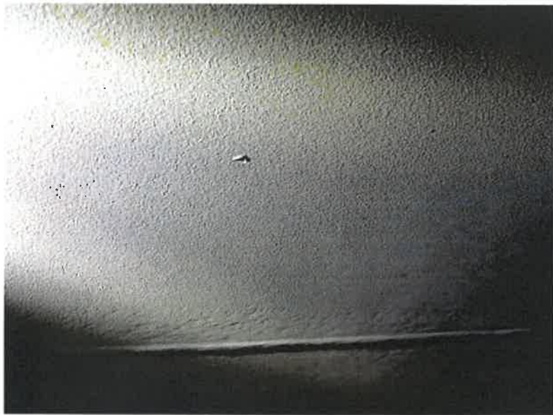
Abb. 22, Bereich DB1 / DB2 außen / Anhang 4, Position 10
