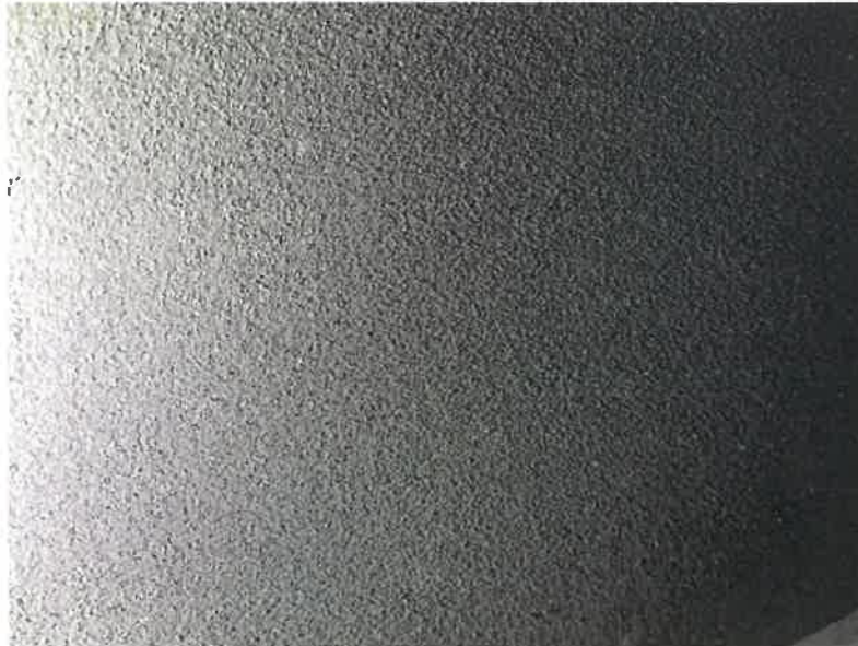
Abb. 5, Bereich TDG 123 - TDG 124 / Beispiel Overspray
