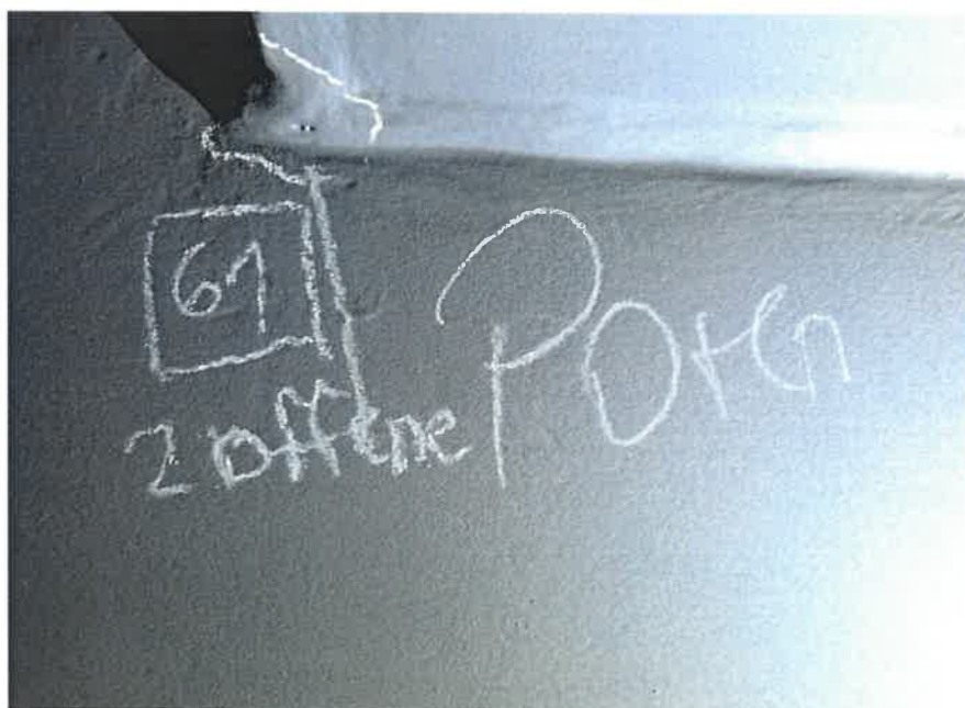
Bild 15 (Prüfpunkt 61- mit zwei zur Oberfläche hin offenen Poren an der Um- schweißung der Verdeckelung der Trapez- hohlsteife)
