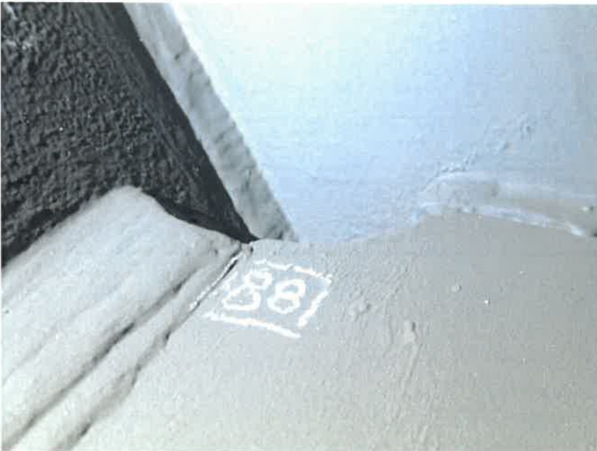
Bild 71 (Prüfpunkt 88- horizontal lie- gende Längs- steife an das Stegblech W1 und TAC 42)
