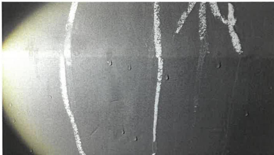
Bild 143 (Detail Prüf- punkt 130 - vermutlich entfernte Hilfsblech- schweißung)
