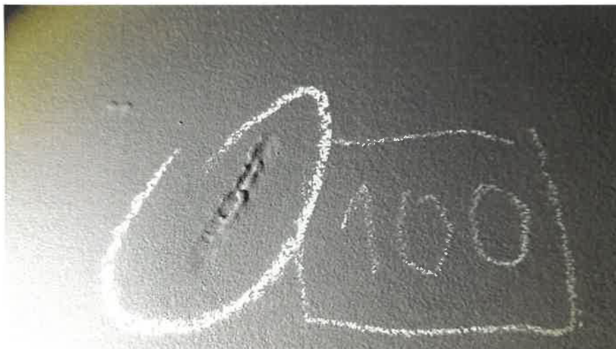
Bild 86 (Prüfpunkt 100 - scharf- kantige mechanische Beschädi- gung in der Quertraverse TAC 42 im Be- reich W2)
