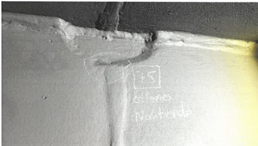
Bild 47 (Detail Prüf- punkt 75 mit offenem Nahtende im Auslauf der Stehnaht)
