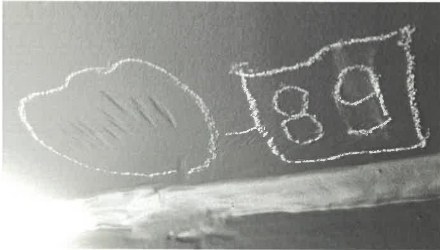
Bild 73 (Prüfpunkte 89 - Detail- Schleifkerben im Deckblech TAC 42 und der Längs- rippe Nr. 3)
