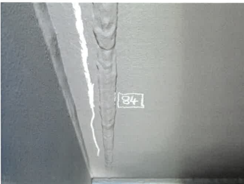
Bild 63 (Übersicht Prüfpunkt 84 – fehlendes Vorlegen / fehlende Zwischenbe- schichtung)
