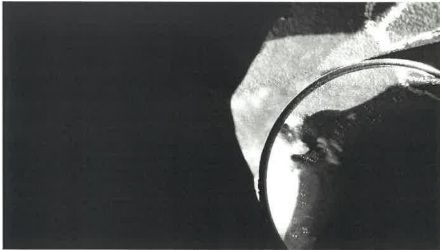
Bild 67 (Detail Prüf- punkt 85 mit fehler- hafter Um- schweißung)
