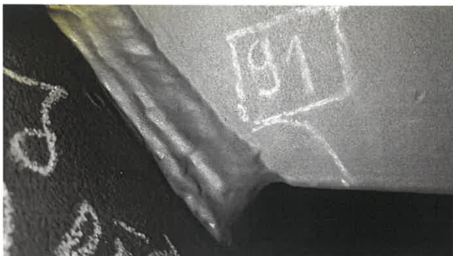
Bild 75 (Prüfpunkt 91- scharfkantige Ecke am Nah- tende und tiefe Unter- schleifung - Klärung durch partielles Freistrahlen erforderlich)
