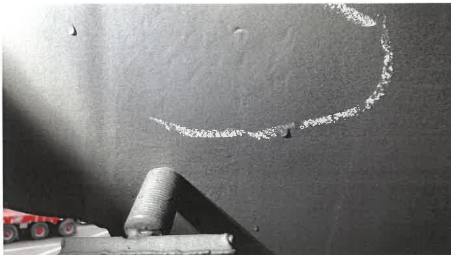
Bild 132 (Detail Prüf- punkt 124)
