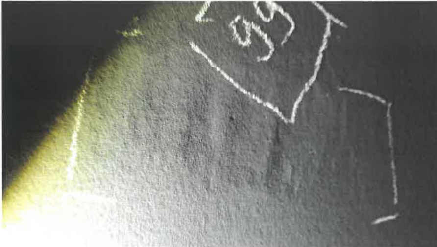
Bild 85 (Prüfpunkt 99 – vermutlich entfernte Hilfsblech- schweißung aufgrund der Lage der An- zeige)
