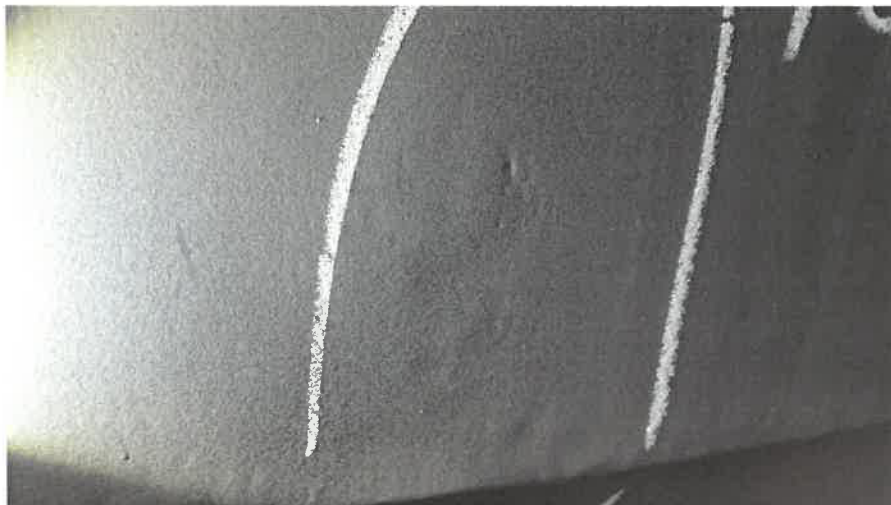
Bild 137 (Detail Prüf- punkt 126)
