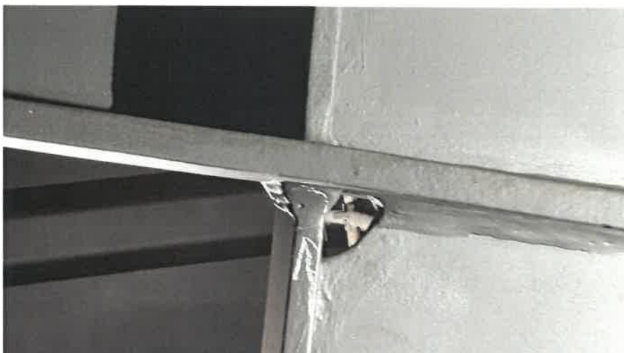
Bild 98 (Übersicht Prüfpunkt 106 mit der offenen Pore in der Umschweißungs-Flansch des Querschotts TAG 126 auf der Seite von W1)
