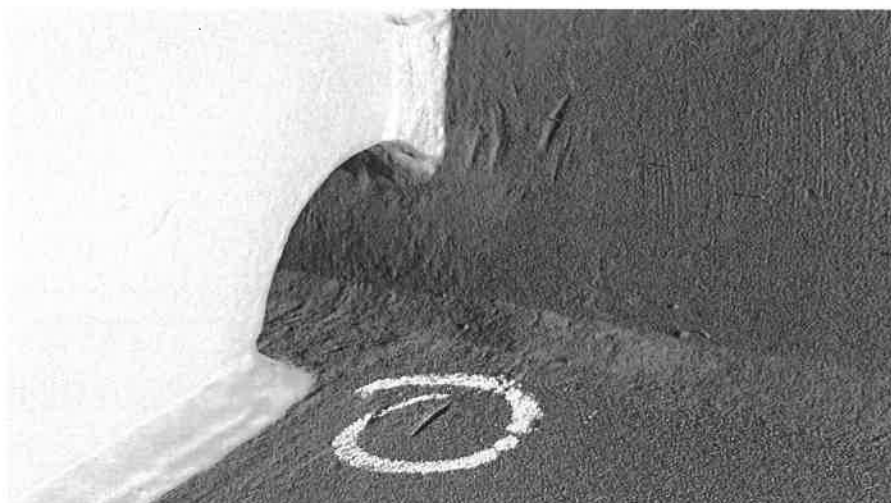
Bild 96 (Übersicht Prüfpunkt 105 - im Hinter- grund am Stegblech W1 ebenfalls Kerben vom Beschleifen der Nähte)
