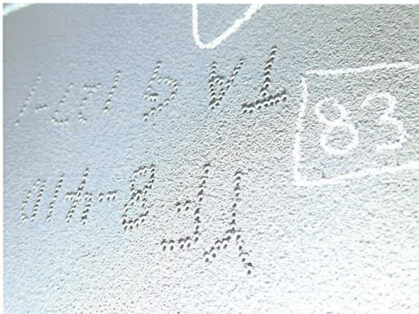
Bild 62 (Prüfpunkt 83 - Hart- stempelung am Quer- schottblech TAG 127 im Bereich des Stegblechs W2)
