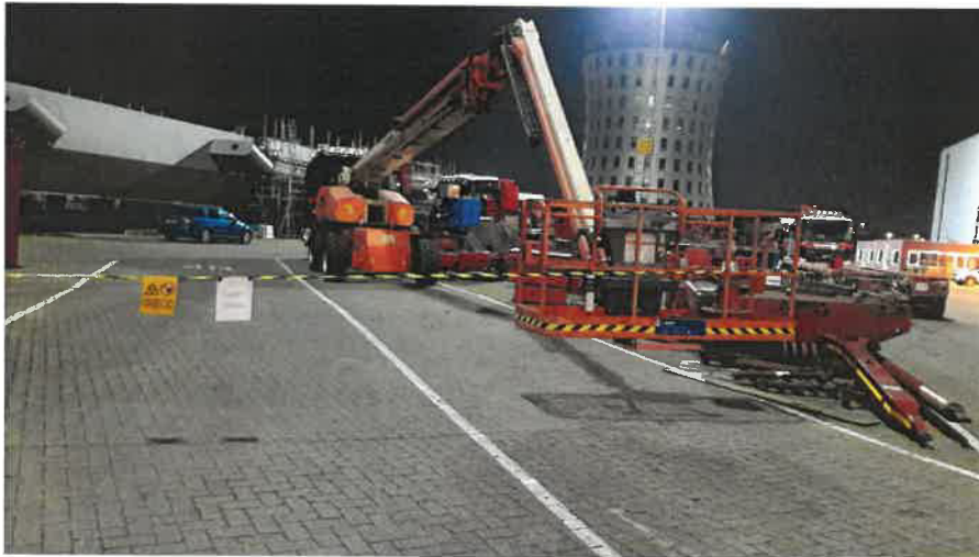
Bild 2 (Mit Flatterband und Schildern abgesperrter Sicherheitsbereich)
