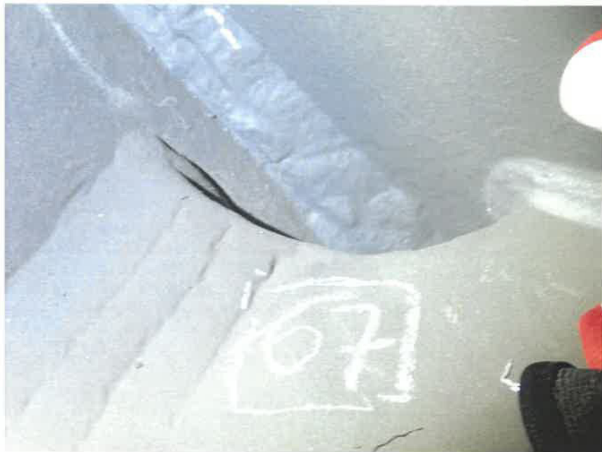
Bild 29 (Prüfpunkt 67 – Detail Frei- schnitt)
