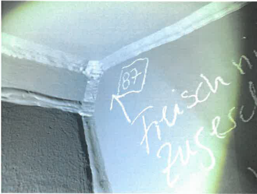
Bild 70 (Prüfpunkt 87 zugeschweiß- ter Freischnitt)
