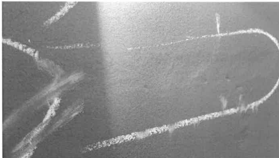
Bild 176 (Prüfpunkt 155 an W2 mit Kerben in der Oberfläche)
