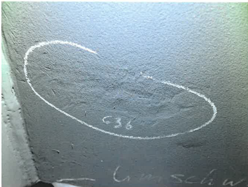
Bild 20 (Prüfpunkt 63b: zur Oberflä- che hin offene Anzeigen an- vermutlich entfernter Hilfsblech- schweißung an der Seil- traverse TAC 41)
