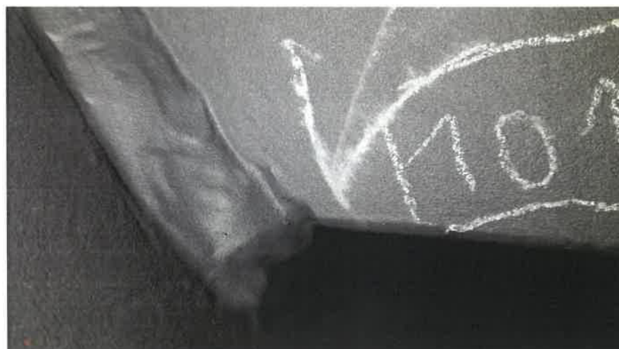
Bild 87 (Prüfpunkt 101- Längs- rippe an Quertraverse TAC 42)
