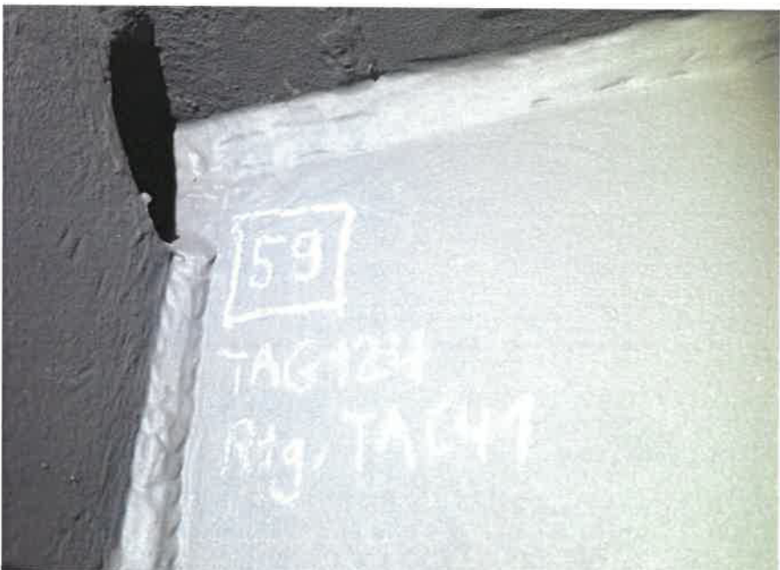
Bild 9 (Prüfpunkt 59- Anschluss der kleinen Längsrippe Nr. 3 an das Querschott- blech auf der Seite des TAC 41 mit fest- stehendem scharfkanti- gen Span)
