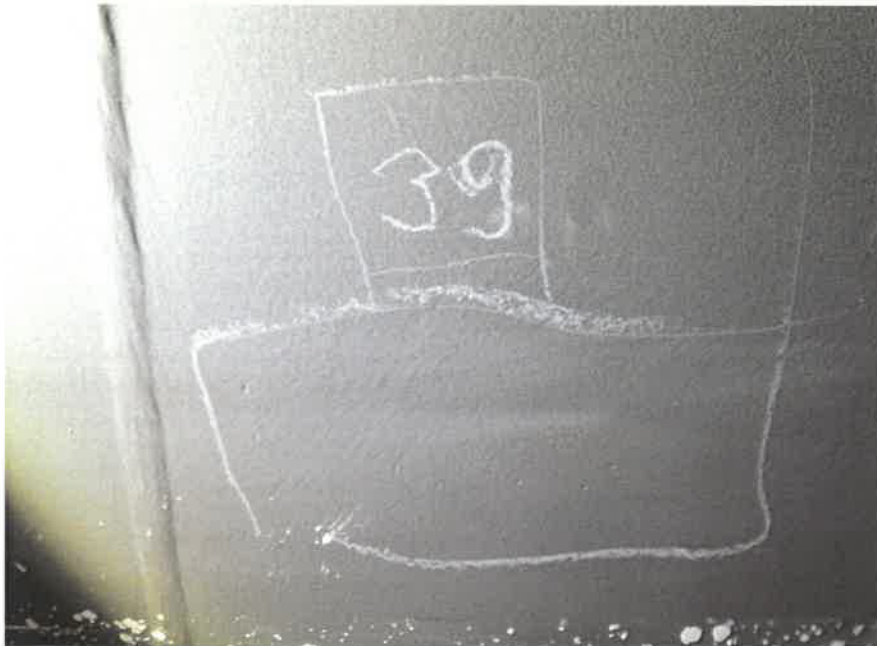
Bild 29 (Prüfpunkt 39-UG: Schleif- An- zeigen im Be- reich der Längsnaht des Boden- blechs quer zur Hauptspan- nungsrich- tung)
