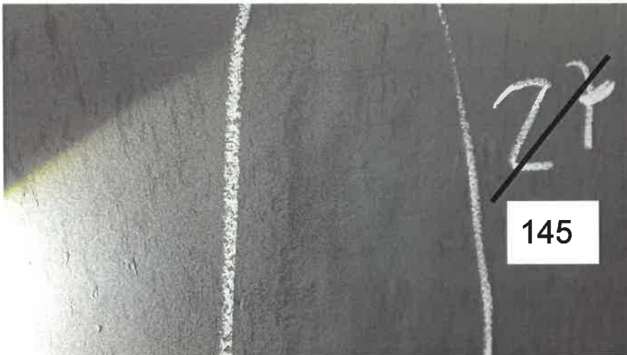
Bild 161 (Detail Prüf- punkt 145)
