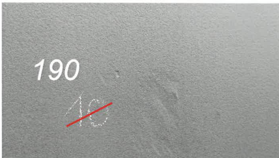
Bild 220 (Übersicht Prüfpunkt 190 mit Schleif- kerben in der Stegwand W1)
