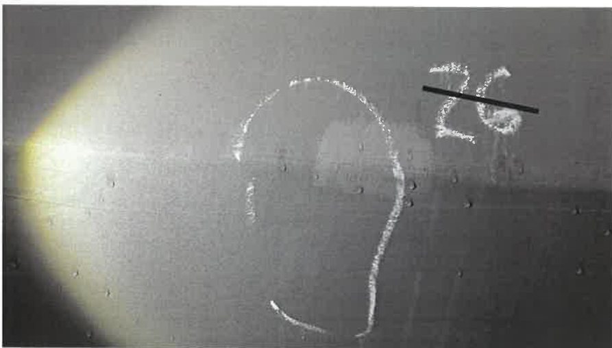
Bild 159 (Detail Prüf- punkt 144)
