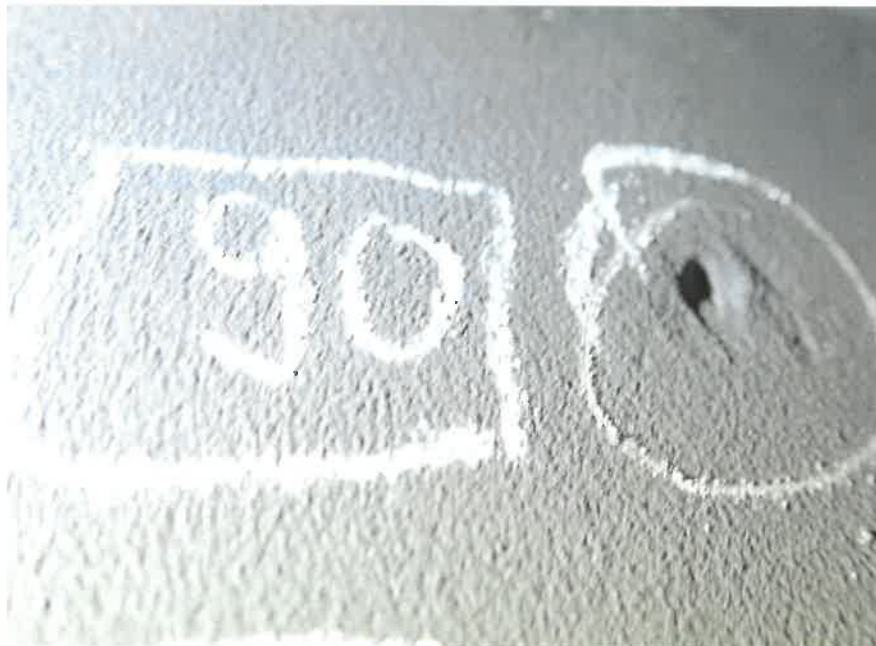
Bild 74 (Prüfpunkt 90 – tiefes Loch zur Ober- fläche hin offen. Vermut- lich eine me- chanische Beschädi- gung)
