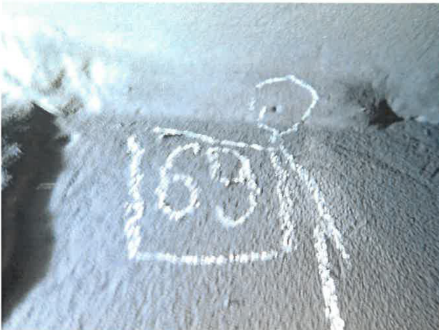
Bild 32 (Prüfpunkt 69 – zur Oberflä- che hin offene Pore in der Schweißnaht)
