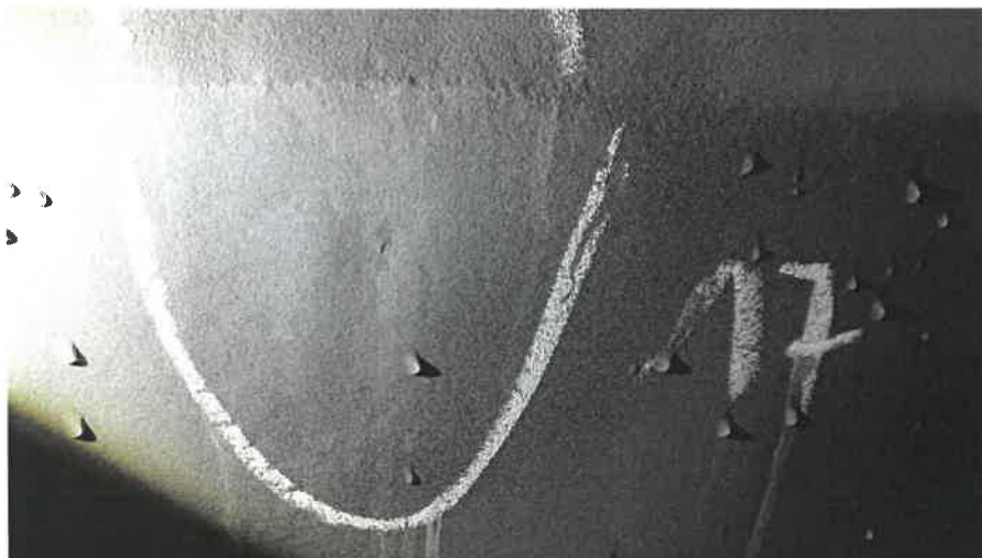
Bild 146 (Detail Prüf- punkt 133)
