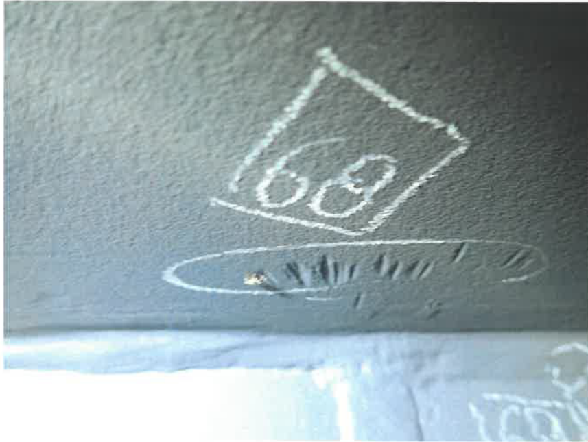
Bild 31 (Prüfpunkt 68 scharfkantige Schleifkerben im Deckblech)
