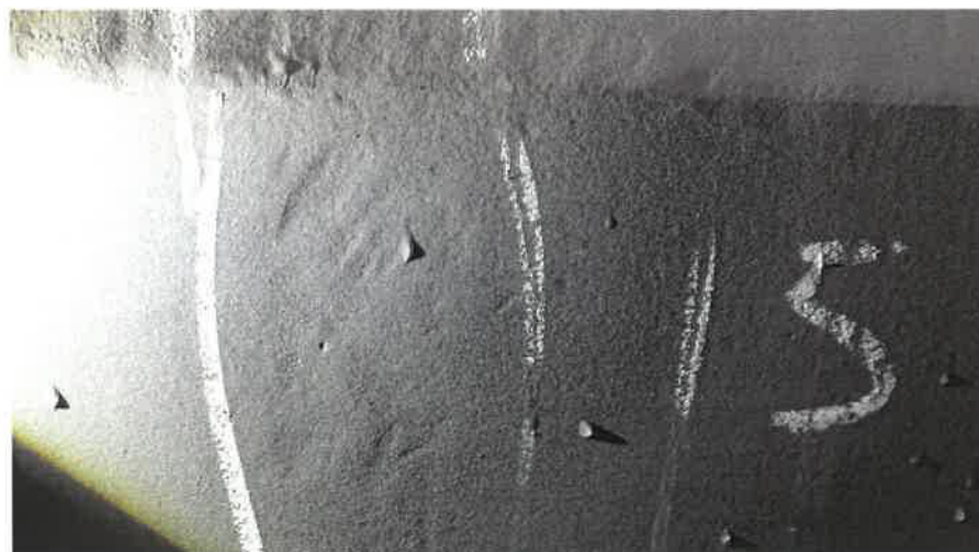
Bild 144 (Detail Prüf- punkt 131)
