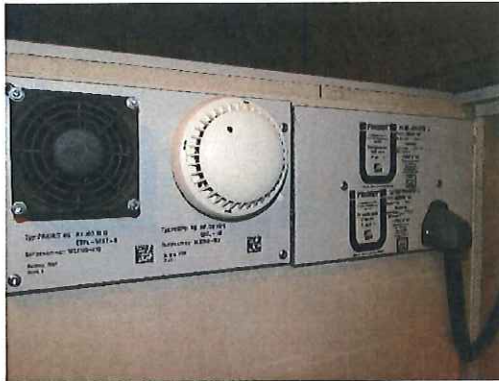
Brandschutzgehäuse der Brandmeldezentrale im EG – Raum ehem. Hausmeisterloge/Technikraum
