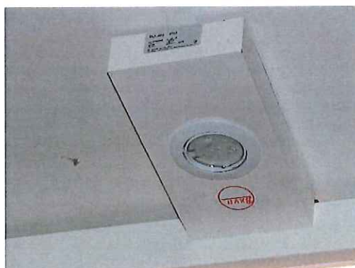
Sicherheitsleuchte im EG – Räume Küche/Mensa
