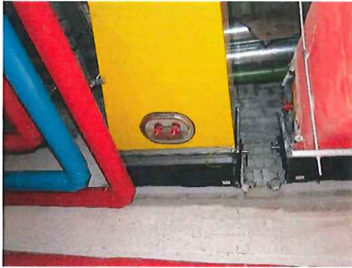
Lüftungszentrale – Brandschutzklappen ohne Stellantrieb
