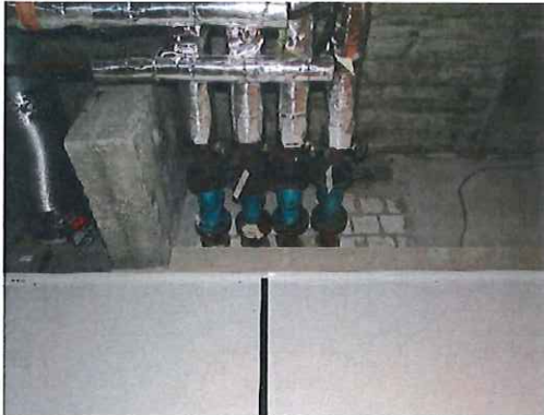
1.OG Flur – Brandschutzmangel
