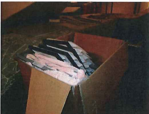
Lüftungszentrale – Mangelhafte Filterlagerung
