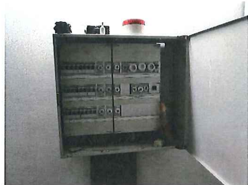
Unterverteilung im UG, NSHV-Raum
