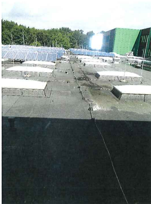
Fanganlagen Blitzschutz auf den Dächern
