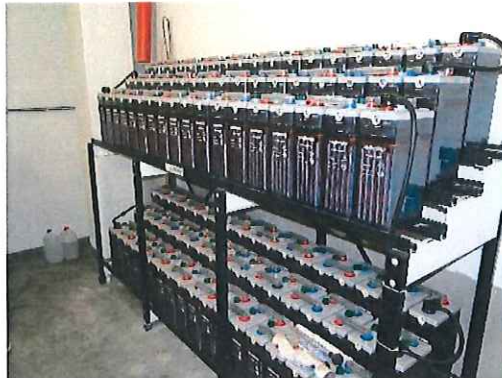
Batterien Sicherheitsbeleuchtung im UG, Batterieraum
