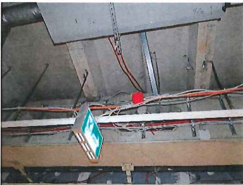
Leitungsinstallation Sicherheitsbeleuchtung im Deckenbereich 1.OG - Flure
