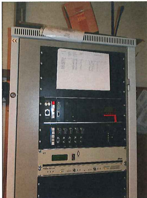
ELA-Anlage im EG – Raum ehem. Hausmeisterloge/Technikraum
