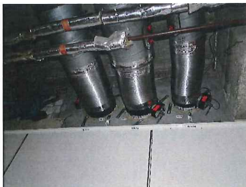
Brandschutzklappen im 1.OG - Flure
