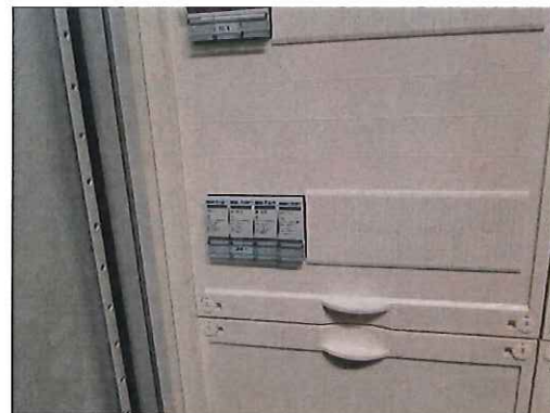
Überspannungsschutz in der UV im EG - Raum ehem. Hausmeisterloge/Technikraum
