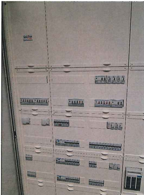
Unterverteilung im EG - Raum ehem. Hausmeisterloge/Technikraum
