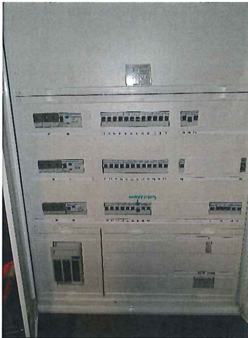
Unterverteilung im 2.OG - Verteilerraum am Treppenhaus B
