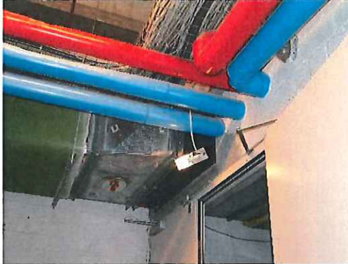
Alte Sicherheitsleuchte im UG, Raum Lüftungszentrale
