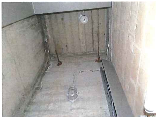
Sicherheitsleuchte im 2.OG - Verteilerraum am Treppenhaus B
