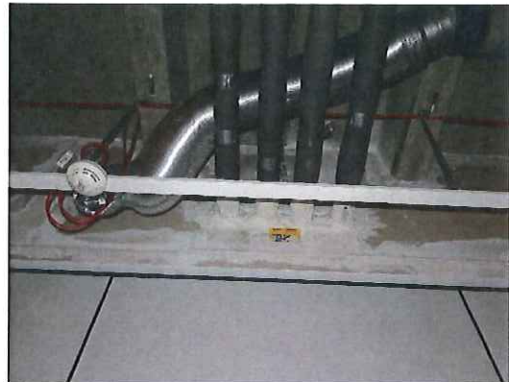
1.OG Flur - Brandschutzdurchführung
