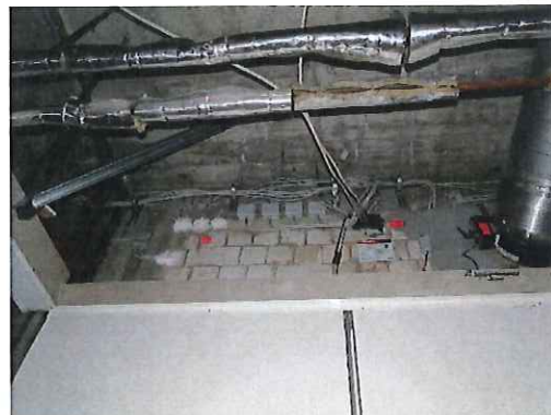
Rohrdurchführungen mit Brandschottungen im 1.OG - Flure
