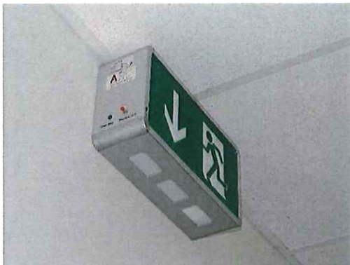
Einzelbatterie-Rettungszeichenleuchte im EG –Raum Chemie 2
