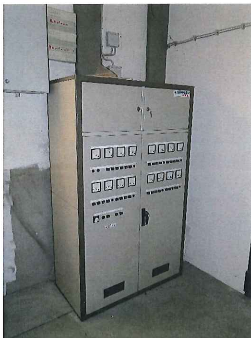
Zentralbatterieanlage im UG, NSHV-Raum
