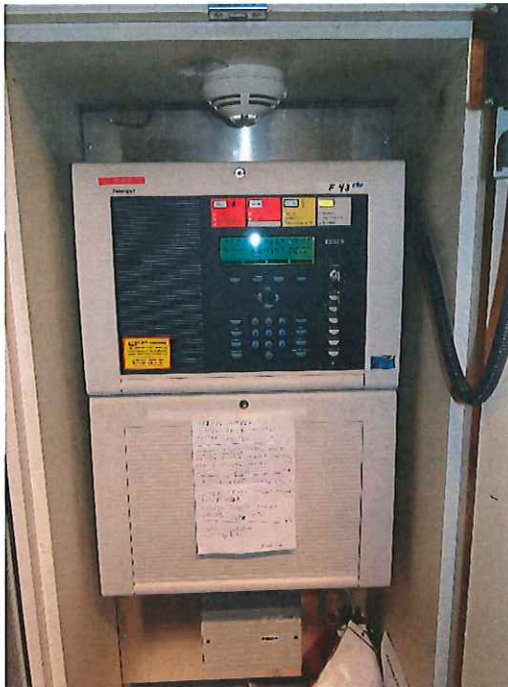
Brandmeldezentrale im EG – Raum ehem. Hausmeisterloge/Technikraum
