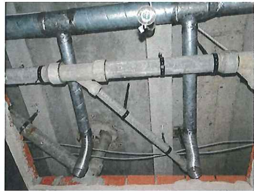
1.OG Lehrer-WC Damen - Brandschutzmangel
