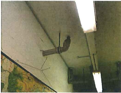
Fehlender Brandschutz Decke Müllraum
