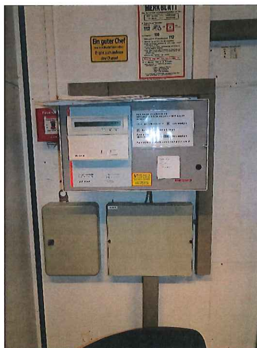
Einbruchmeldezentrale im EG – Raum ehem. Hausmeisterloge/Technikraum
