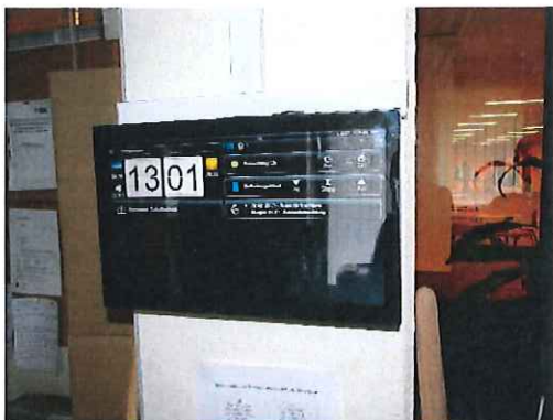
Touch Panel im EG – Raum Hausmeister Verwaltungsbereich
