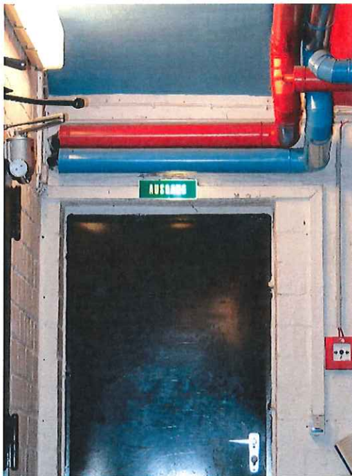
Alte Sicherheitsleuchte im UG, Raum Lüftungszentrale
