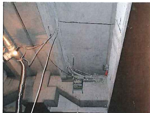
Leitungsführung im Deckenbereich im 1.OG - Raum Herren WC
