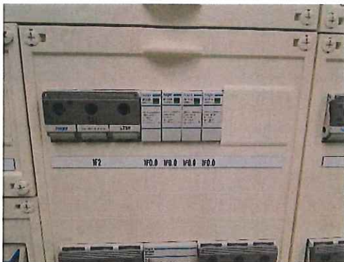
Überspannungsschutz in der UV im EG – Raum Sammlung Biologie
