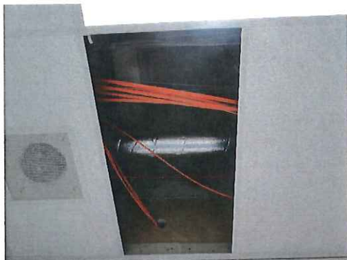
Unbefestigte Leitungen im Deckenbereich im EG - Raum 033
