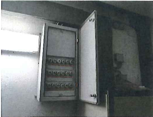
Unterverteilung Si-Bel im UG, NSHV-Raum
