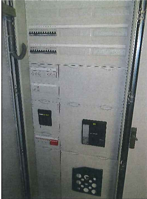
Blitzstrom- und Überspannungsableiter in NSHV
