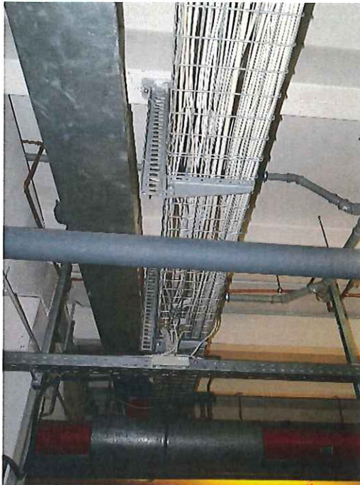
Leitungsführung im Deckenbereich im UG, Raum Heizungszentrale
