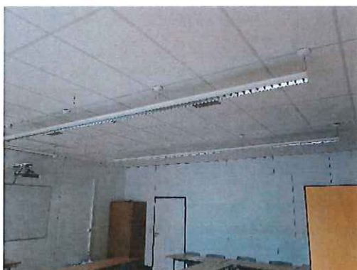
Beleuchtung im 1.OG - Klasse Raum 131
