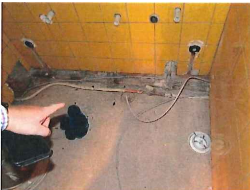
1.OG Lehrer-WC Herren – Rohrbeschädigung/Querschnittsverengung
