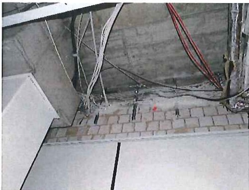
Leitungsführung im Deckenbereich im 1.OG - Flure
