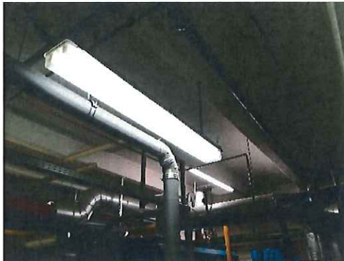
Beleuchtung im UG, Raum Heizungszentrale
