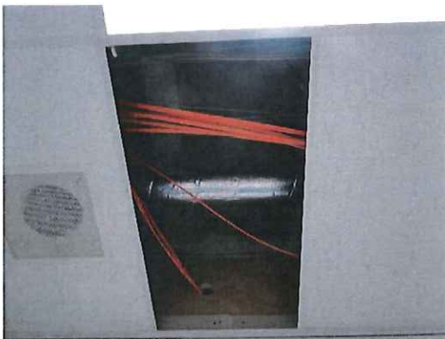
Leitungsführung im Deckenbereich im EG - Raum 033
