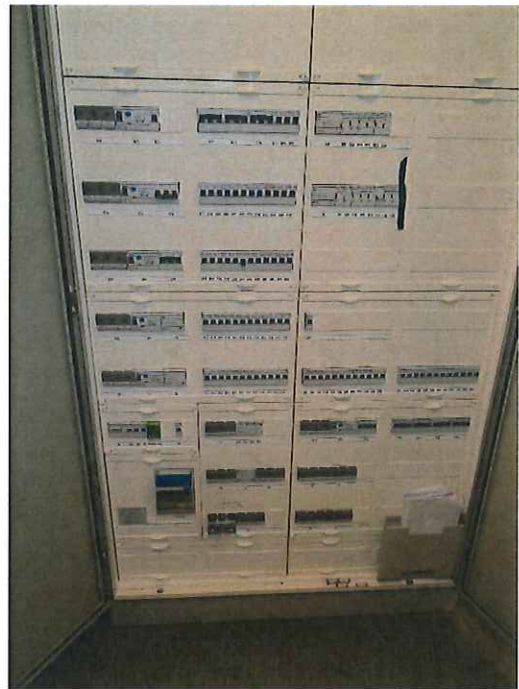
Unterverteilung im EG - Raum Sammlung Biologie
