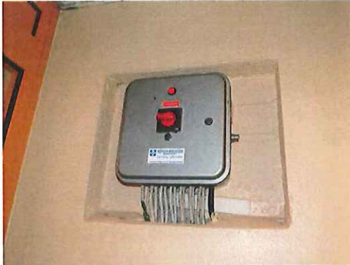
Aufzugsteuerung Lastenaufzug im UG - Flur
