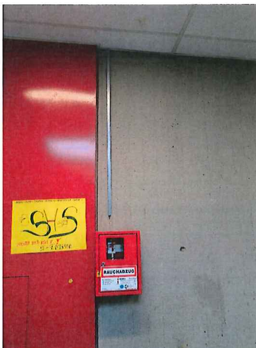
RWA-Zentrale im 2.OG - Treppenhaus B
