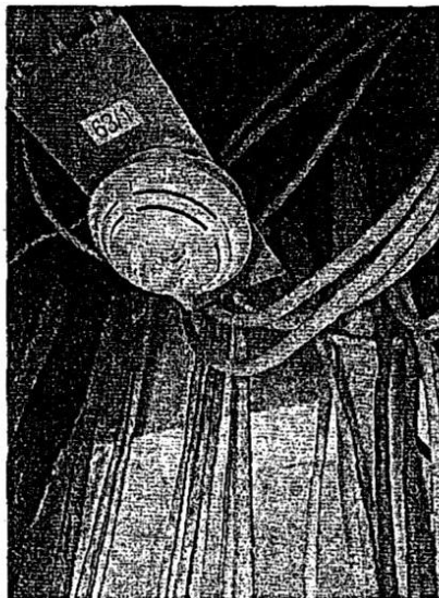
Abbildung: Installierter Rauchmelder im senkrechten Steigeschacht auf ca. 1,50 m Höhe
