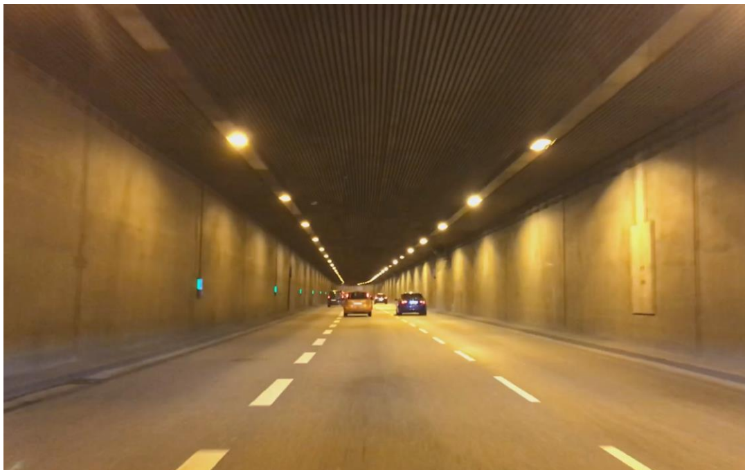
Abbildung 6: Beleuchtungsanlage im Tunnel
