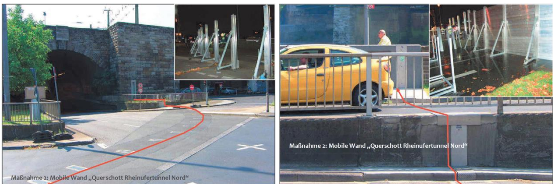
Abbildung 27: Mobile Wand „Querschott Rheinufertunnel Nord“ [4]
