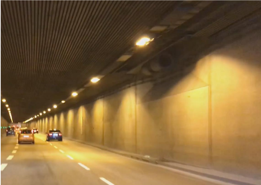
Abbildung 7: Strahlventilator im Bereich der Tunneldecke an der Außenwand
