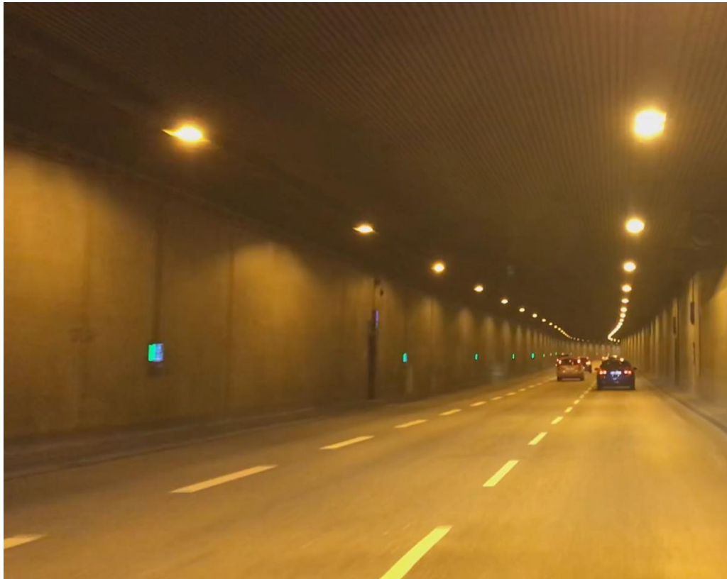
Abbildung 2: Tunnelmittelwand aus Beton ohne erkennbare Farb- und Brandbeschichtung
