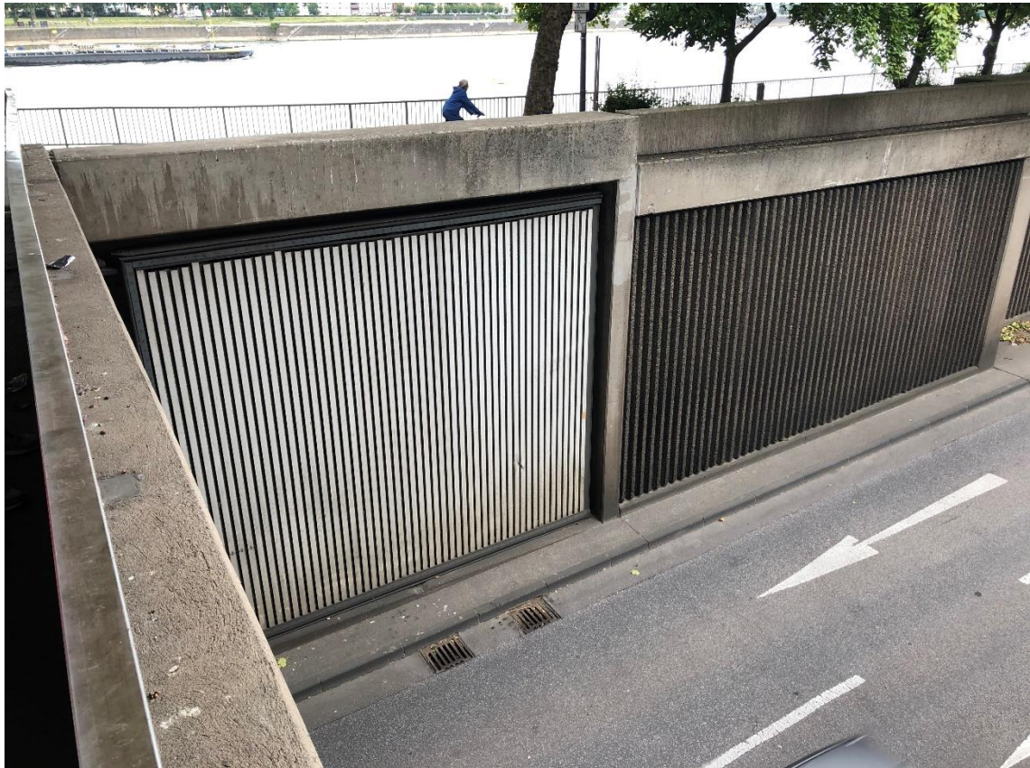
Abbildung 25: Hochwasserschutztor im Bereich der südlichen Rampe
