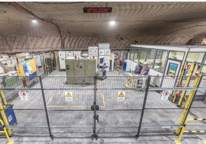
Prüffeld für transportable 5 Kilovolt-Stationen einrichten
