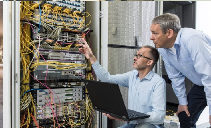
Stefan Kadoić, Jörg Horand beim Sicherheitscheck im Rechenzentrum der BGE-Zentrale
