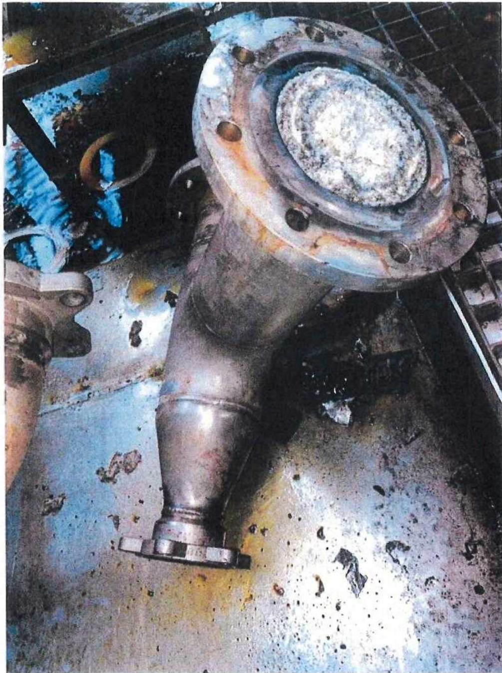
Abbildung 4: Ablagerungen in der Zirkulationsrohrleitung (Absorber 2)
