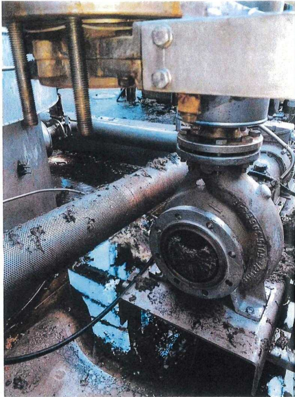
Abbildung 3: Ablagerungen in der Zirkulationsrohrleitung (Absorber2)
