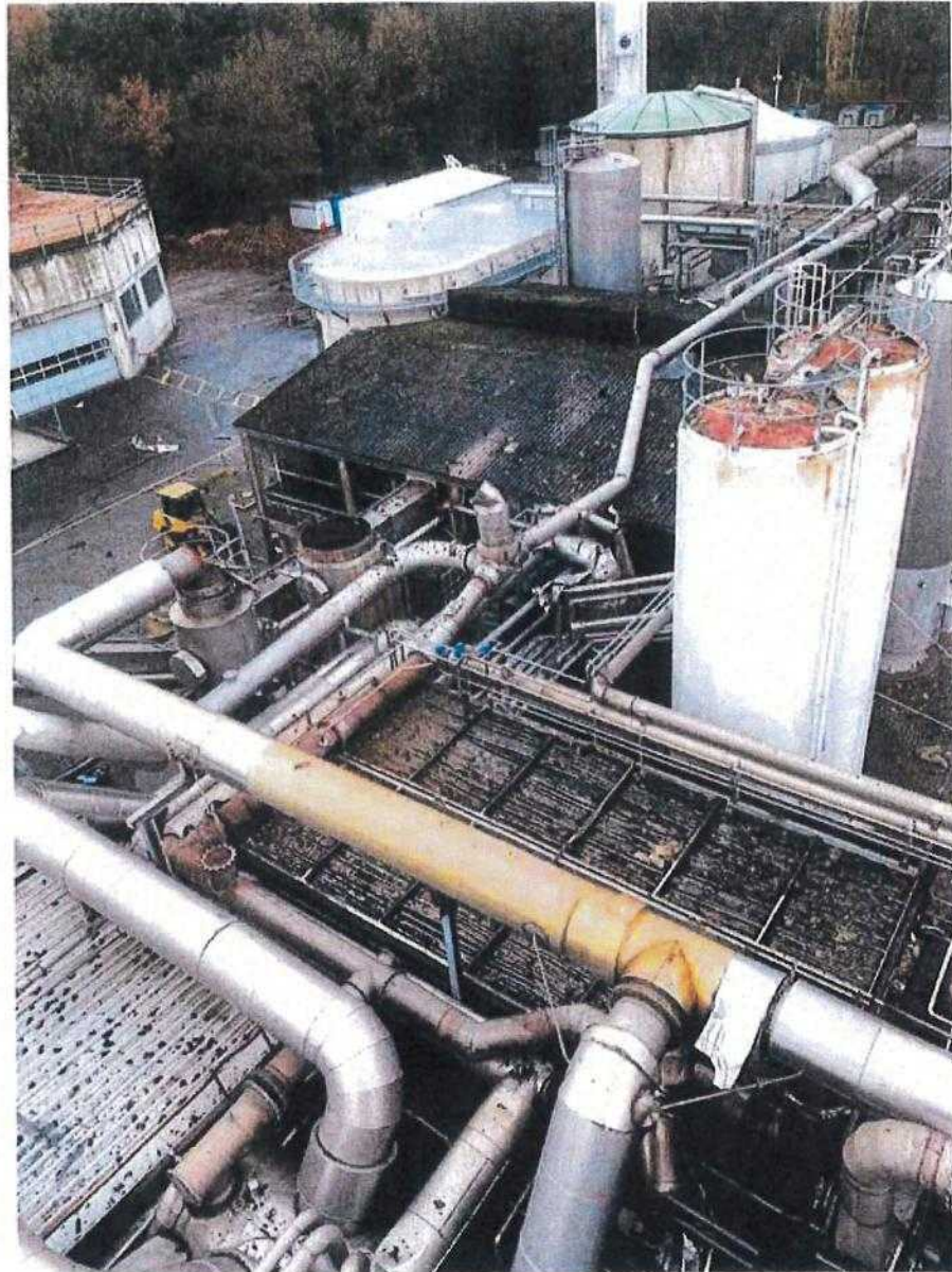
Abbildung 2: Aufnahme des betroffenen Anlagenteils (Mitte links, der Absorber 2 mit den abgerissenen Rohrleitungsteilen; unten rechts, abgerissene Rohrleitungsteile am Ventilator; die dunklen Partikel sind herausgeschleuderte Füllkörper)
