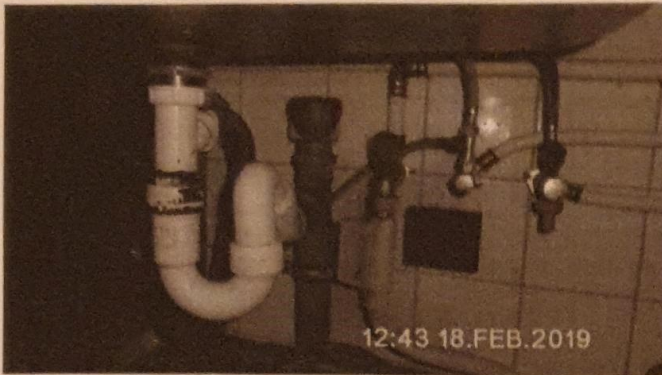
Verunreinigter Wandbereich unter der Spüle
